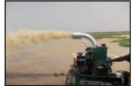
Bombeo de Agua
